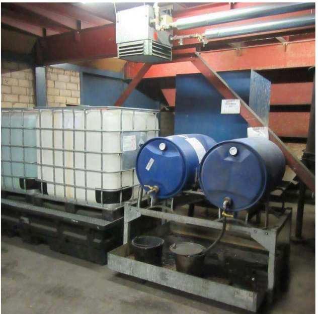
Lagerung wassergefährdender Stoffe mit Auffangwannen.
